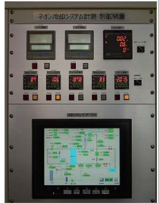
ネオン冷凍機 計測制御装置
