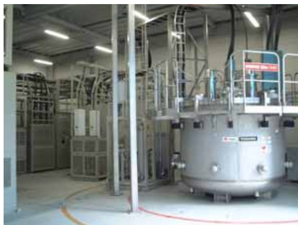
図3 超電導コイルシステムの外観
