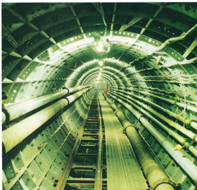
図 1 送電ケーブル用洞道
