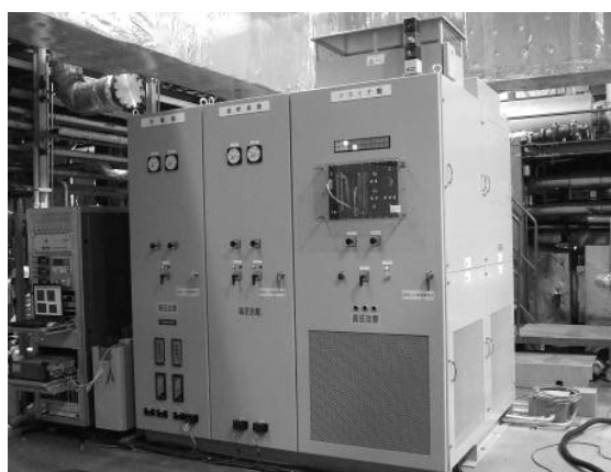
図2 限流器盤 (受電盤、遮断器盤、クライオ盤からなる)
