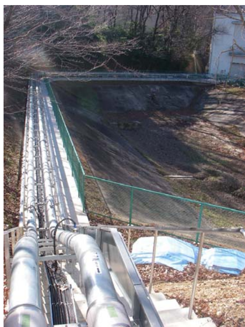
図 2 断熱 2 重管（実験棟外部）
