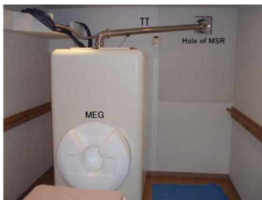
図 2 名大医学部用 HCS。TT は既設シールドの換気孔を通して室外に設置した冷凍チャンバに結合されるため約 3 m になった。
