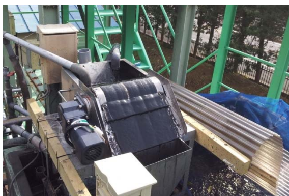
図 1. パイロットプラントに設置されたドラム型磁気分離装置
