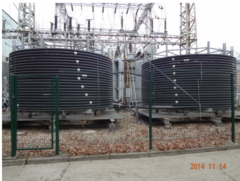
屋外暴露中の直流超電導ケーブルとジョイント（中央部に少し見えている）
