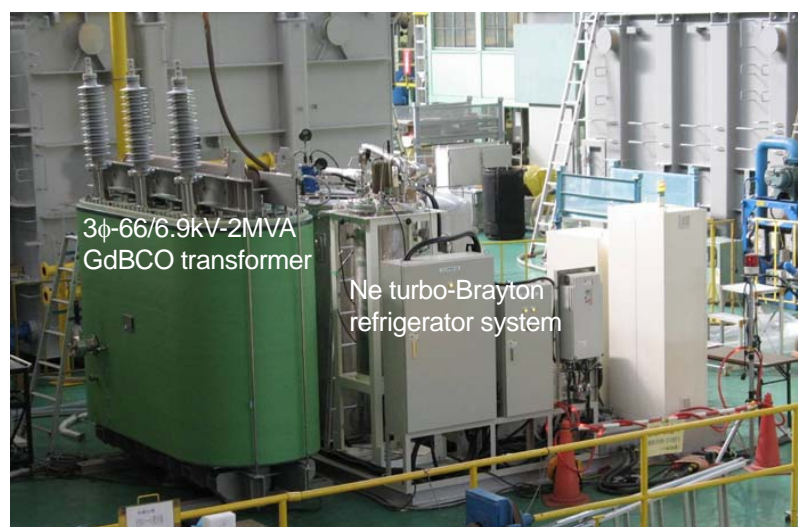
図5 3φ-66/6.9kV-2MVA-液体窒素冷却超伝導変圧器システム
