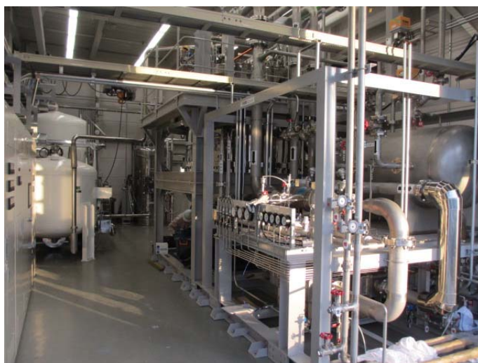
図 1 旭変電所に移設したブレイトン冷凍機
