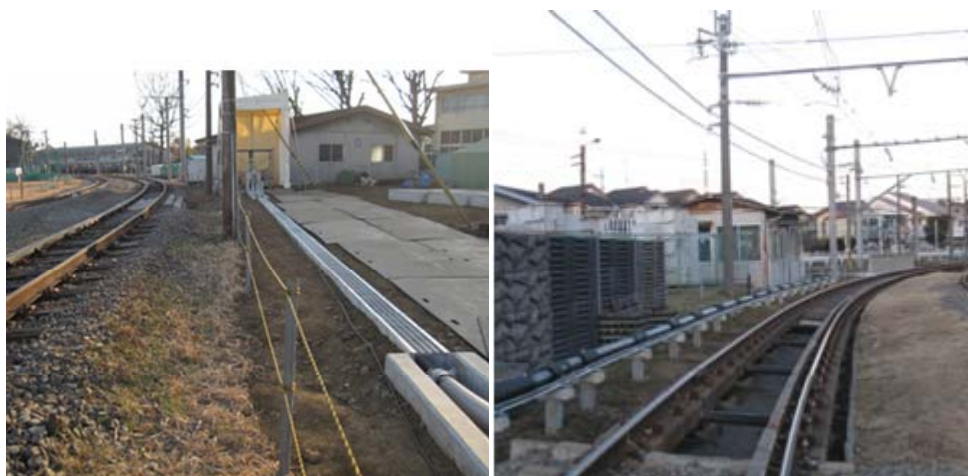
図 4 構内試験線に敷設した超電導き電ケーブル例 (左：30 m 級ケーブル、右：300 m 級ケーブル)
