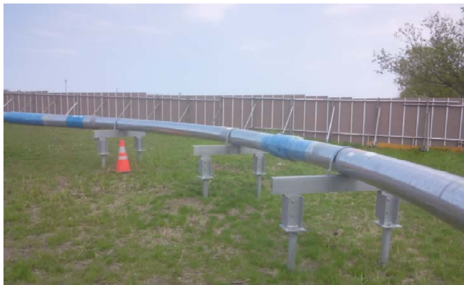
図 2 断熱管の曲がり部
