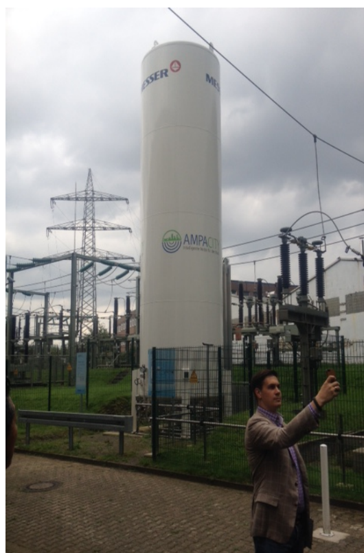
ケーブル用液体窒素タンク（高さ 15m）
