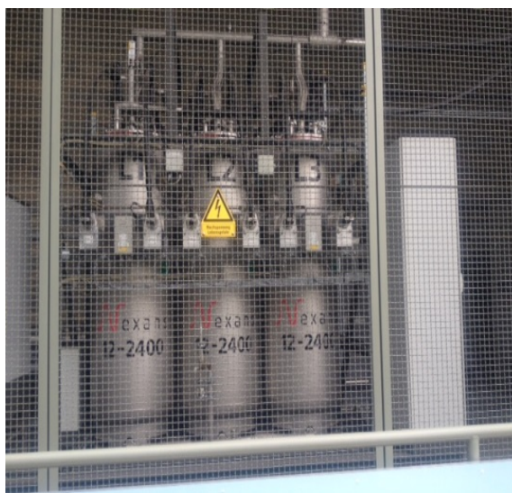
超電導限流器 (YBCO 系線材を使用)。上図矢印に収納されている。
