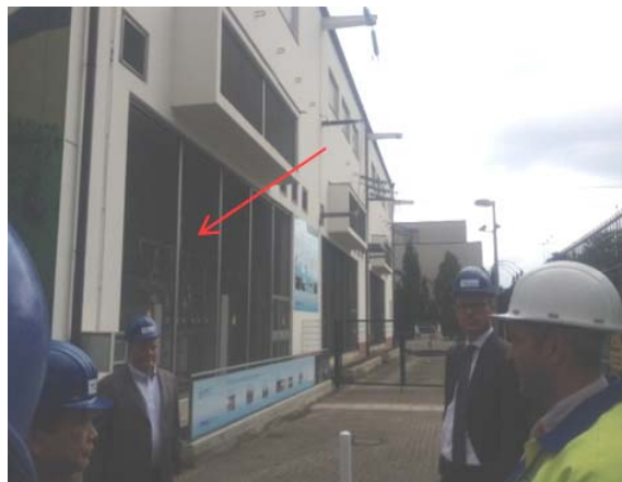
高温超電導設備全景 (変電所内)。矢印の箇所に、ケーブル(Bi)の出口、限流器 (下記) が収納されている。
